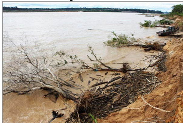
Figura 1. Barrancos da margem do bairro Triângulo desmoronando
